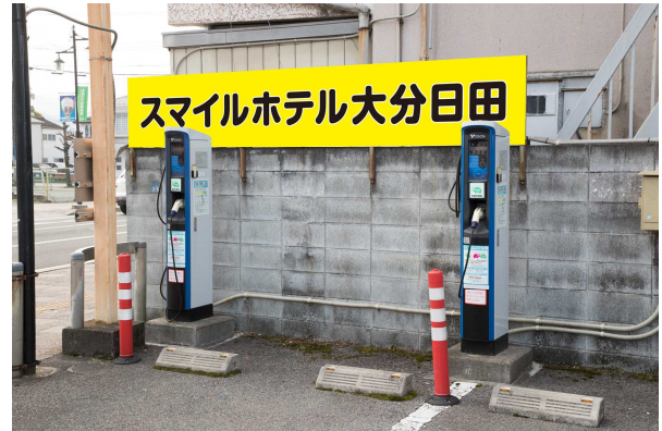
駐車場 (電気自動車充電スタンド)
